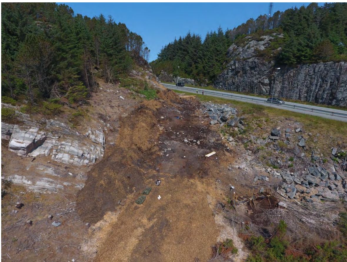
Figur 13 Dronebilde av Lokalitet 3 sett mot NØ. En ser her tydelig veifyllingen øst for lokaliteten.
