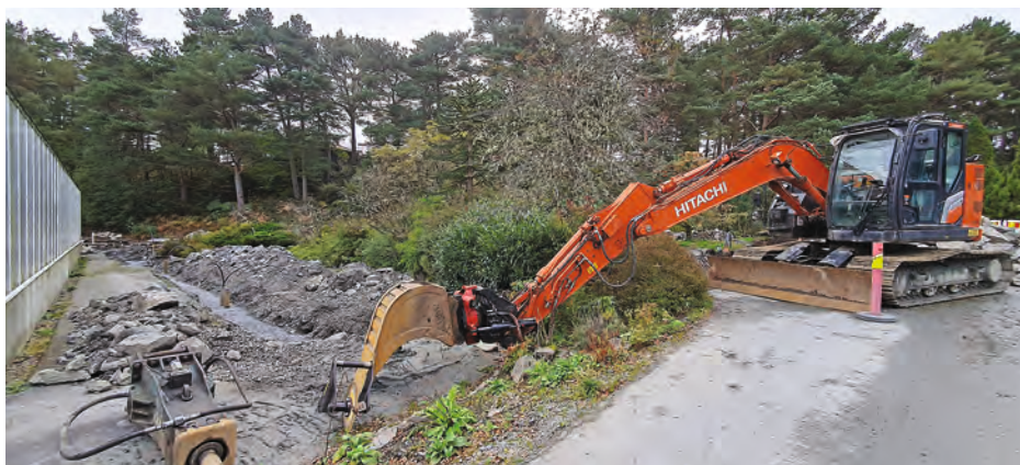
Anleggsmaskinene inntar området ved Veksthuset i Arboretet på Milde for å grave ned bergvarmeanlegget (foto: Terhi Pousi, 1. oktober 2023).
