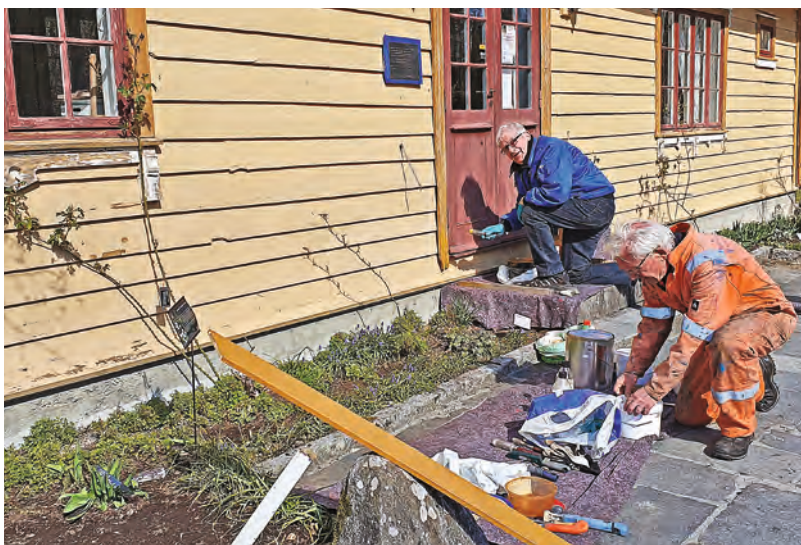
Blondehuset pusses opp utvendig: Etter skrapping og vask, går Dag Mjelstad og Fredrik Sørvig løs på vegger, dører og vinduskarmen med malerkost (foto: Terhi Pousi, 8. april 2022).
