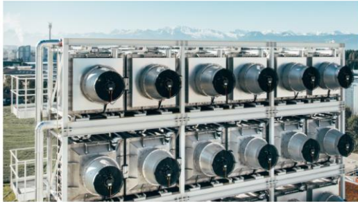
Climeworks jobber med å fjerne klimagassen CO 2 fra vanlig luft. Bildet viser et pilotanlegg montert på taket til et avfallsforbrenningsanlegg i Hinwil, Sveits.
