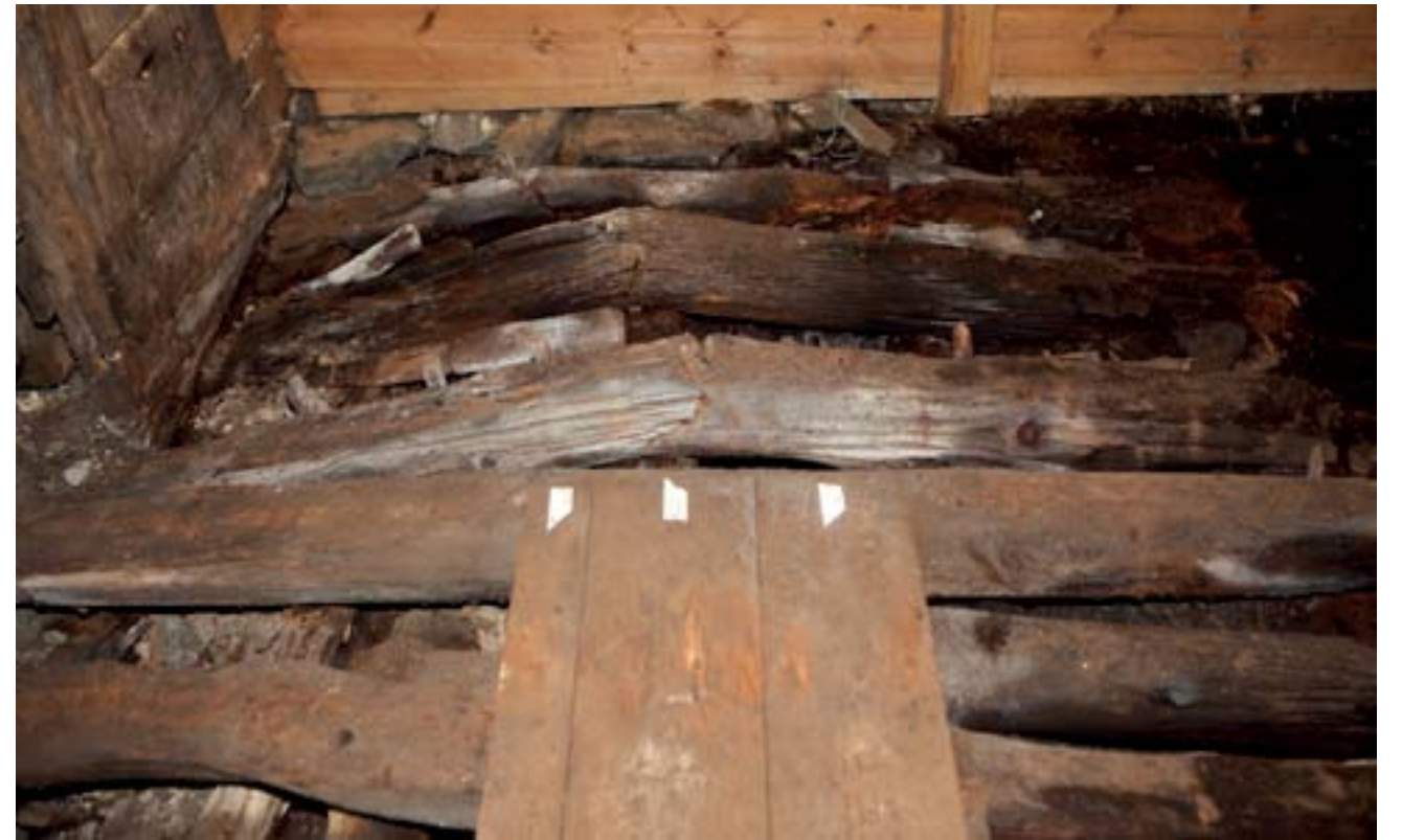
■ Figur 4. Slik ser gulvet ut stedvis på Bryggen. Ustabil grunn fører til store setningsskader i overgangen mellom bygning og kulturlag. Fotograf Line Møllerhaug.
