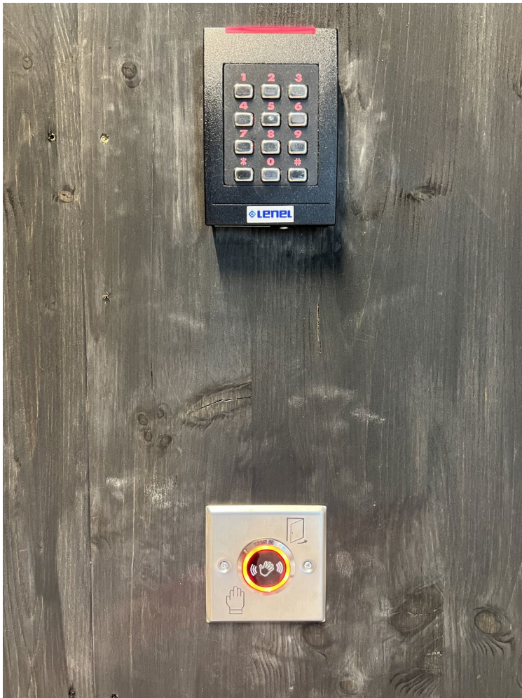
Figur 5 Adgangskontrollert dør utside
