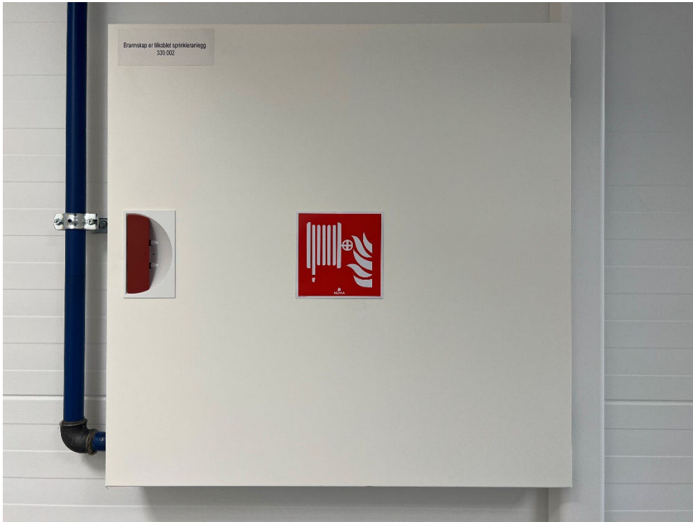
Figur 21 Skap til brannslanger med merking
