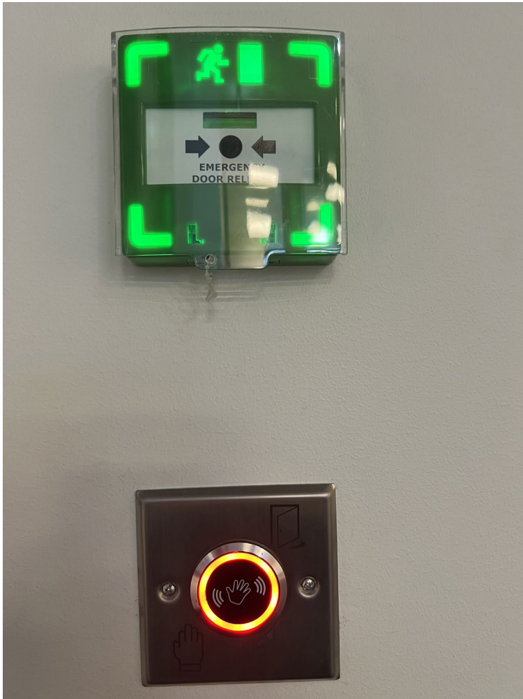
Figur 6 Adgangskontrollert dør innside
