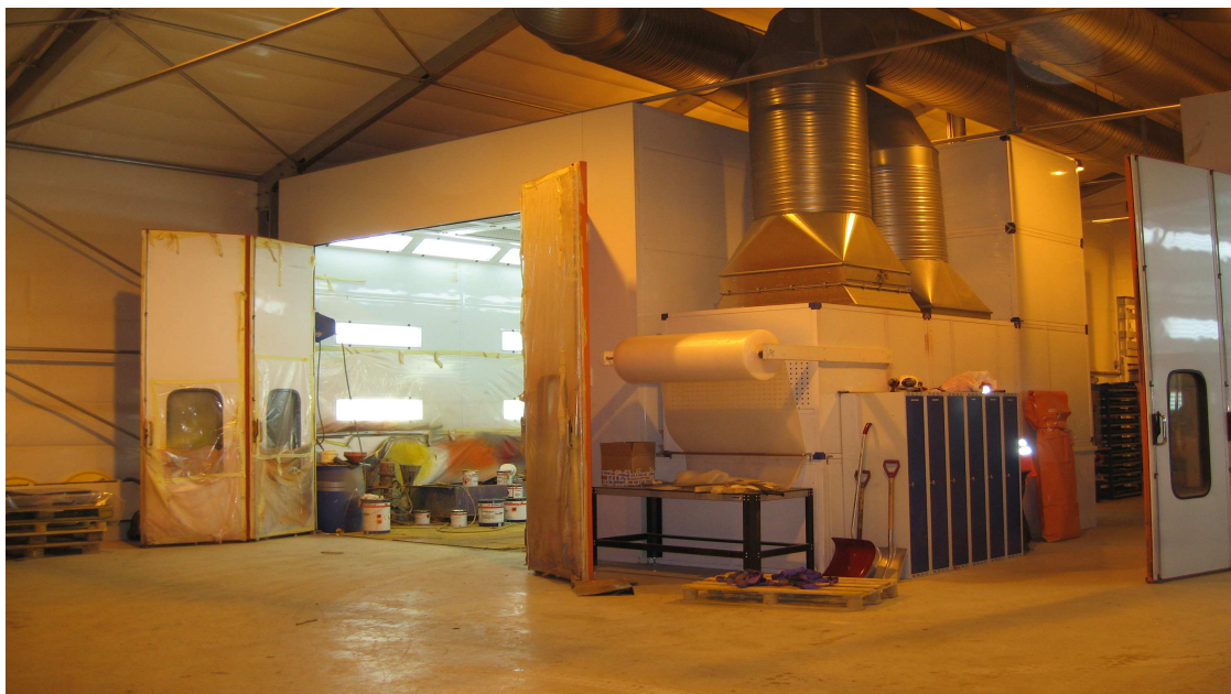
Figur 6.2. Her vises inngangen til en lakkeringsboks. Dette er et rom med god ventilasjon, der maling og lakking kan foregå uten at noen av de kjemiske stoffene kommer utenfor dette rommet. På den måten beskyttes arbeidstakere i rommet utenfor. Videre er ventilasjonen så god at arbeidstakere inni rommet kan jobbe med kjemiske stoffer uten å ta skade, i alle fall hvis de i tillegg bruker personlig verneutstyr.
