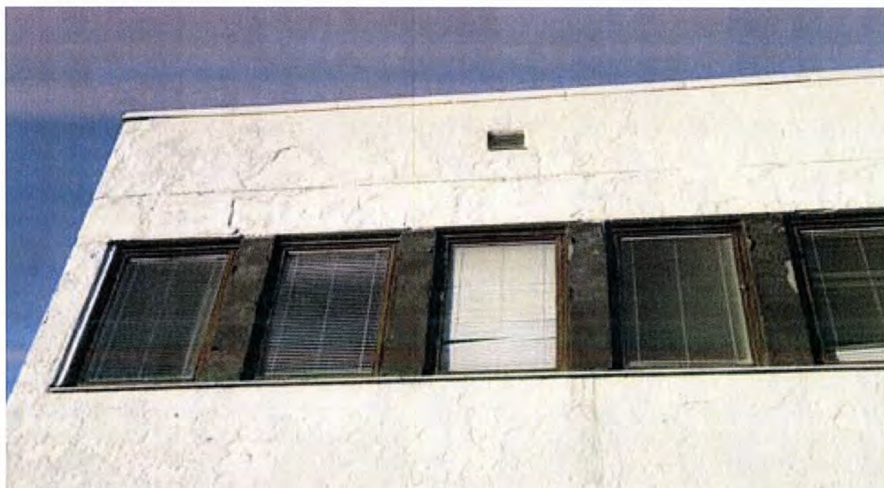
Eksempel på bygg i dårlig tilstand.
