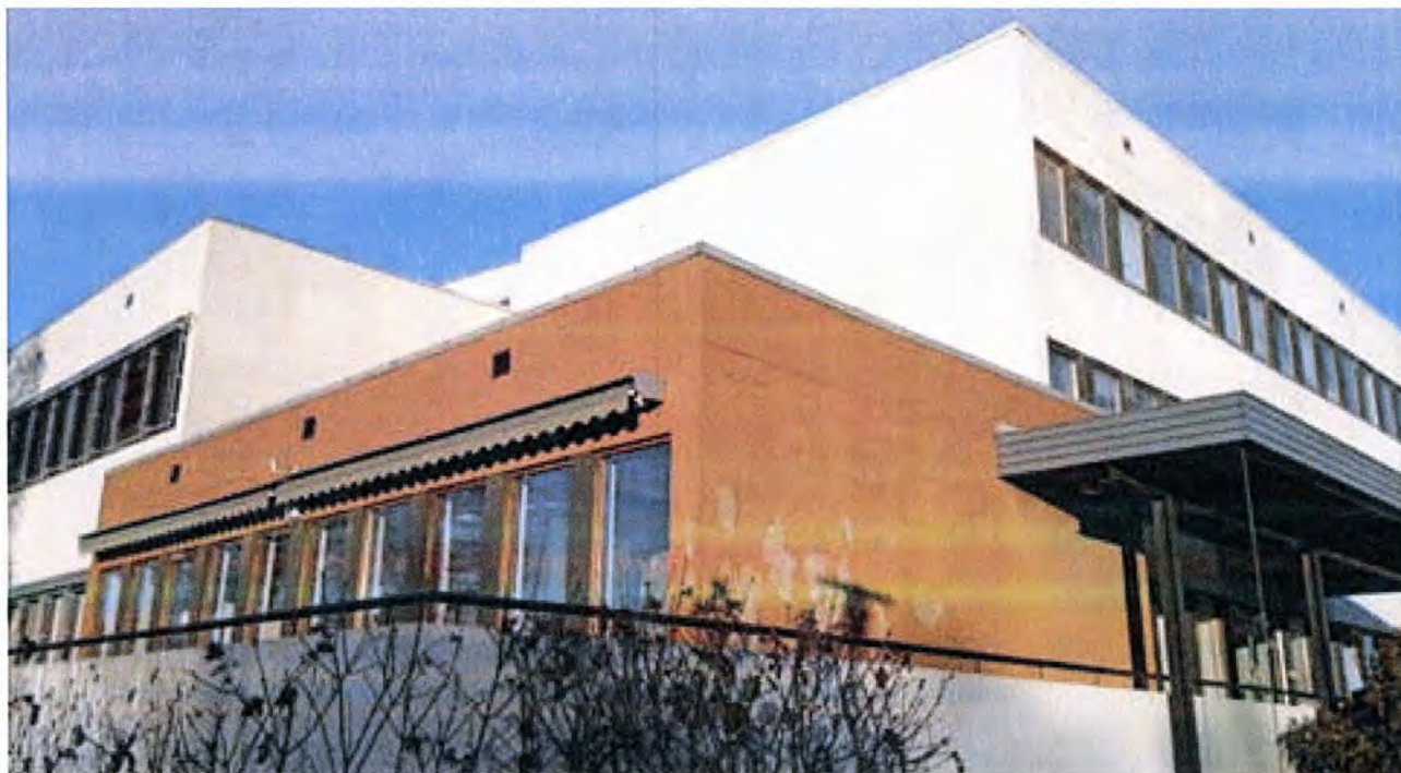
Eksempel på bygg i dårlig tilstand.
